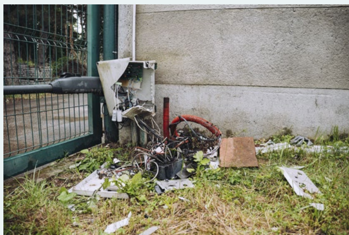
Skříň rozbočení komunikační sítě JIS (vpravo, zcela zničená) a ovládání brány „ČOV“ (vlevo její zbytky)
