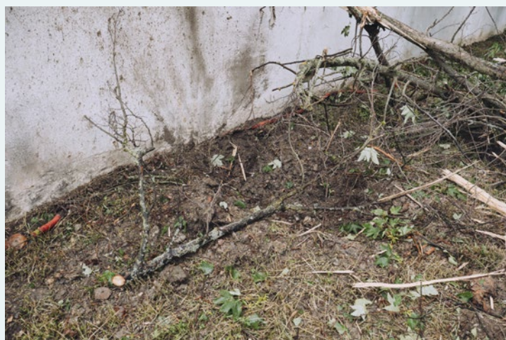
Detail místa vstupu bleskového proudu do kabelové sítě NCB – červená chránička podél stěny
