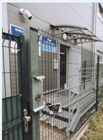
Zvonek, JIS a ovládání branky pro pěší do areálu "prádelna"; v pozadí u dveří další poškozená čtečka JIS
